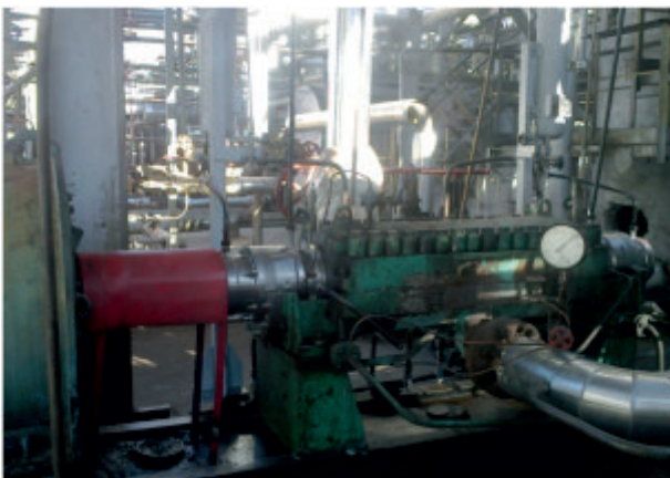
Насос НПС с БПУ в работе
